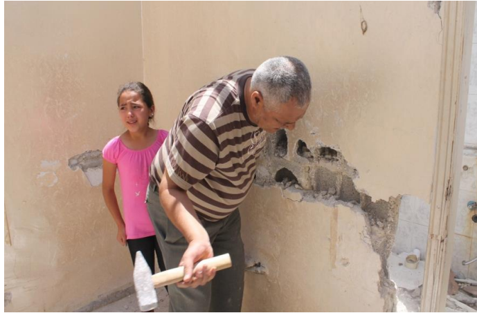
الشكل 9: فتاة فلسطينية تنتظر في زهول إلى سلطات الاحتلال في بلدية القدس، التي تجبر والدها على هدم منزل العائلة بيده. المصدر: مركز أبحاث الأراضي - القدس
